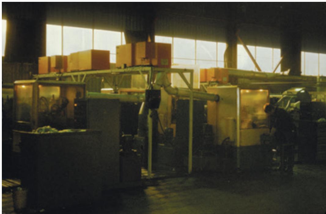
Рис. 3.14. Электростатические фильтры ЭФВА-МС-1-01, стационарный, с вентилятором. Очистка воздуха от масляных туманов при шлифовке режущих инструментов.
