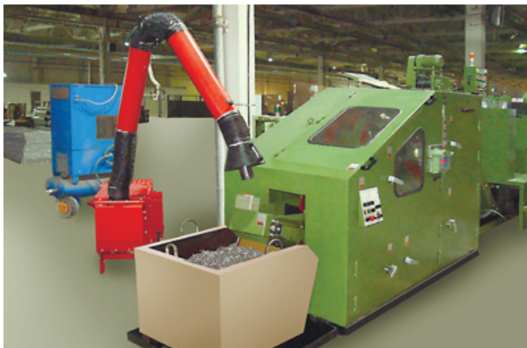
Рис. 3.17. Электростатический фильтр ЭФА-МС-1-06, стационарный, с вентилятором. Улавливание масляного тумана при изготовлении крепежных изделий.
